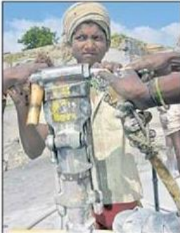
Dieser Junge arbeitet mit schwerem Gerät im Steinbruch, besucht keine Schule und schädigt seine Gesundheit.
